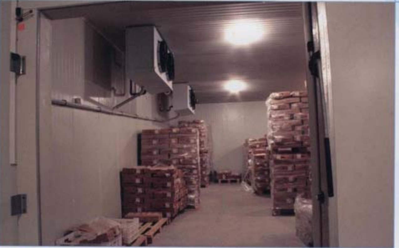
2 Soğuk Hava Deposu İç Görünüm
