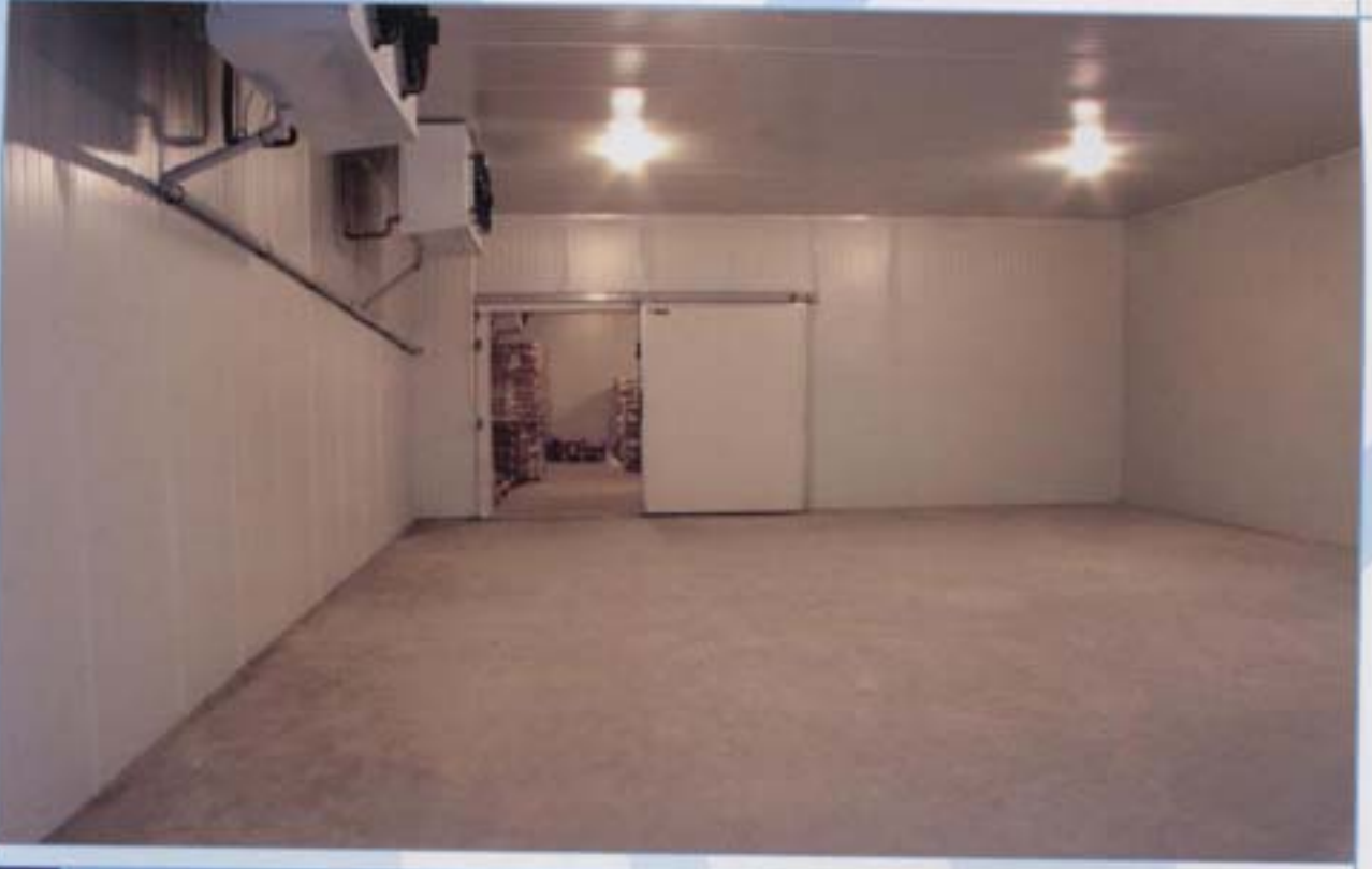
3 Soğuk Hava Deposu
